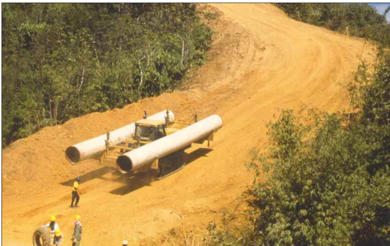
Des travailleurs construisent le gazoduc de Yadana dans la région de Tenasserim
